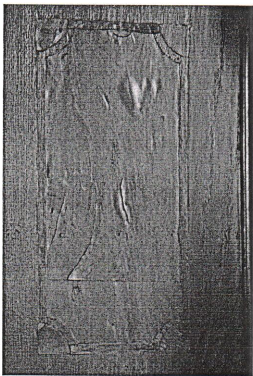
Fot. 7. Zniszczenia okleiny
