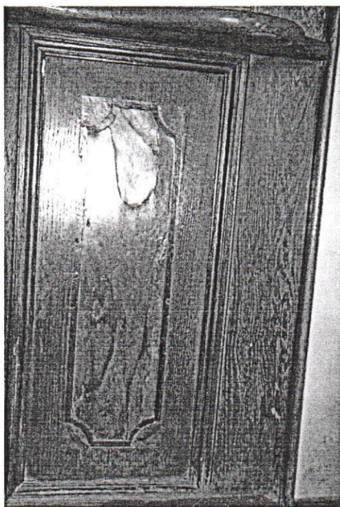
Fot. 9. Zniszczenia okleiny
